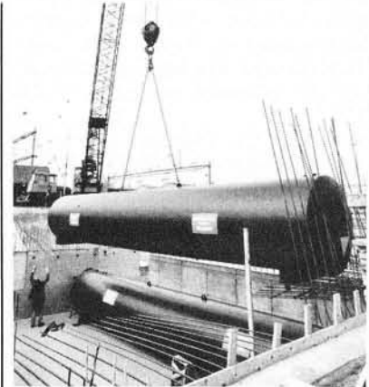
7 dieser Heizöltanks mit einem Gesamtvolumen von 190'000 Litern wurden im 2. Untergeschoss plaziert.
